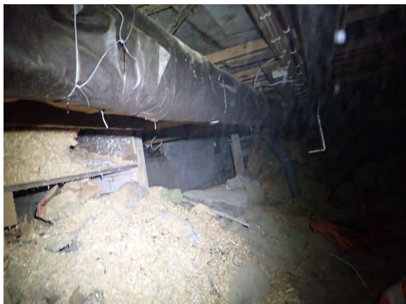
Kuva 9. Kuva ryömintätilasta. Ryömintätilassa orgaanista ainesta pohjalla. Osin alapohjan eristemateriaalia romahtanut.
