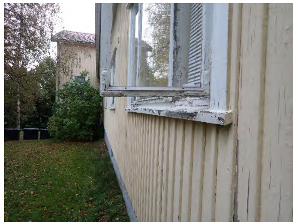
Kuva 6. Yleiskuva ikkunasta. Ikkunoissa korjaustarvetta.
