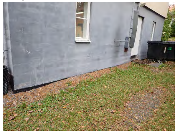
Kuva 4. Yleiskuva julkisivusta. Julkisivun maalipinta huonokuntainen. Rapaumaa havaittavissa.
