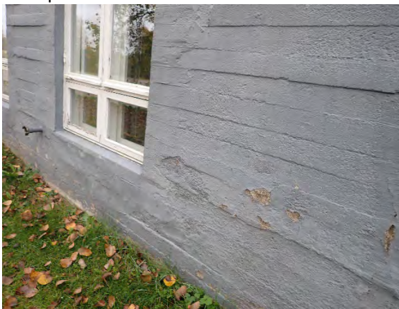
Kuva 3. Yleiskuva julkisivusta. Julkisivun maalipinta huonokuntainen. Rapaumaa havaittavissa.
