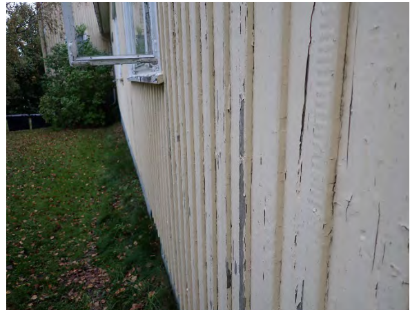
Kuva 2. Yleiskuva julkisivusta. Julkisivun maalipinta huonokuntainen.
