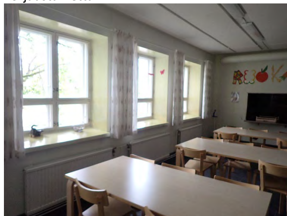
Kuva 8. Yleiskuva luokahuoneesta. Ikkunapielien pielen materiaali kellastunut.
