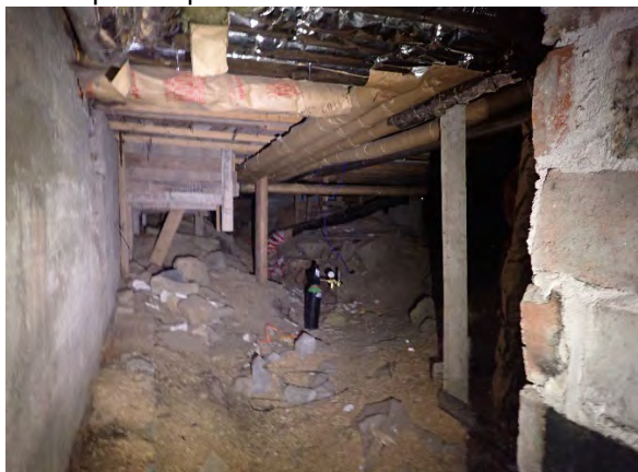
Kuva 10. Kuva ryömintätilasta. Ryömintätilassa orgaanista ainesta pohjalla.
