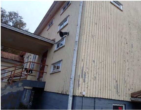
Kuva 1. Yleiskuva julkisivusta. Julkisivun maalipinta huonokuntainen.
