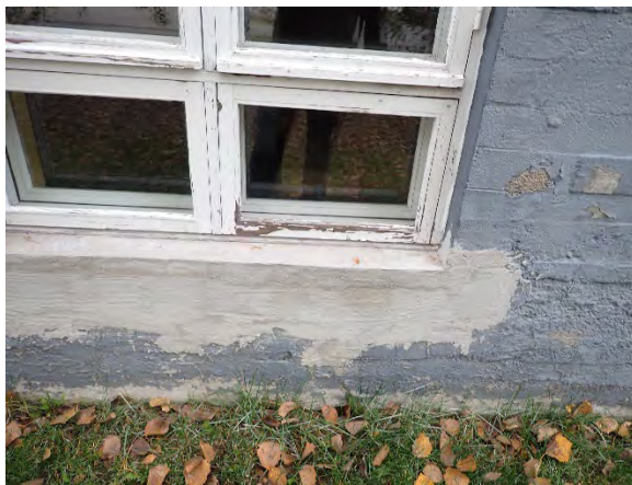
Kuva 5. Yleiskuva ikkunasta. Ikkunoissa korjaustarvetta.
