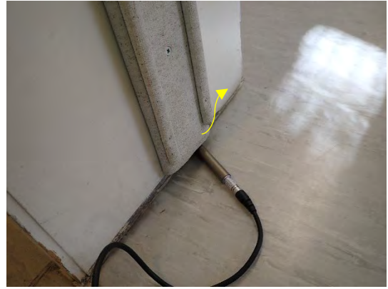
Kuva 6. Todettuja ilmavuotokohtia lattian epäjatkuvuuskohdista.
