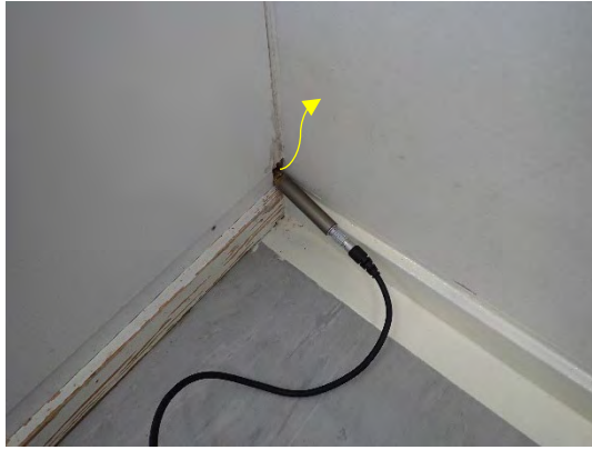
Kuva 5. Todettuja ilmavuotokohtia lattian epäjatkuvuuskohdista.
