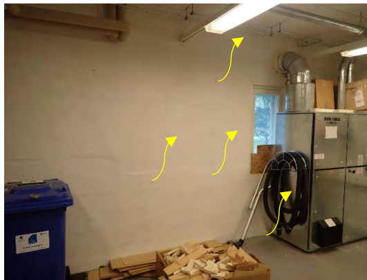
Kuva 2. Todettuja ilmavuotokohtia lattia ja seinän rajapinnasta sekä seinässä sijaitsevista kiinnitysrei'istä.
